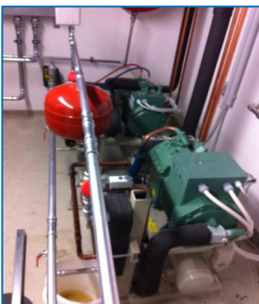
Munz Kältemaschinen mit Anschluss an die Wärmerückgewinnung über Plattenwärmetauscher
